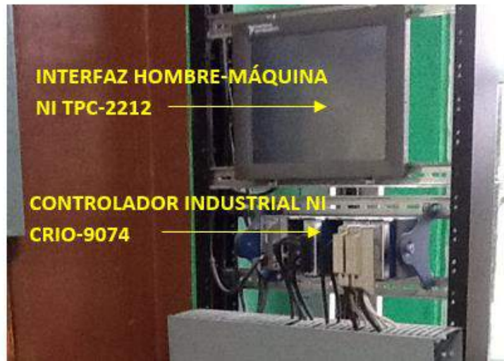
Figura 3. Sistema de control del simulador de procesos industriales.
